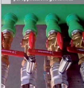
8 Collettori di distribuzione per applicazione geotermica
